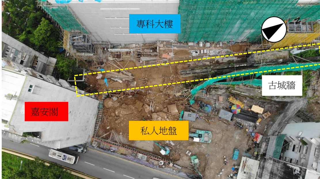
圖 1 古城牆倒塌範圍俯視圖
