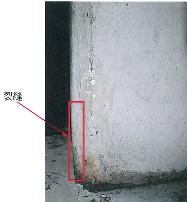
圖 3、編號 2F-P17 的鋼筋混凝土柱開裂細節
