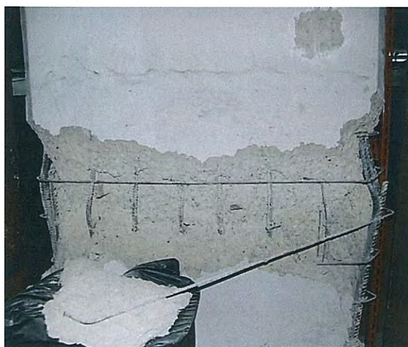
圖 2、編號 2F-P9 的鋼筋混凝土柱破壞細節
