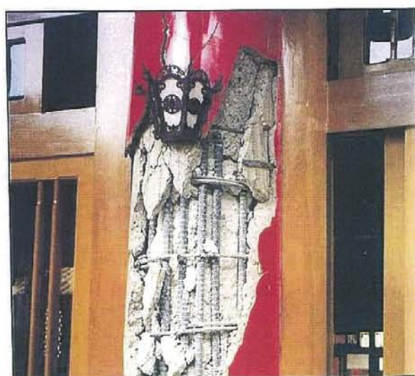
圖 1-6、柱軸力破壞相關照片
